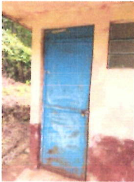
PUERTA, SUSTITUCION DE PUERTA EN MAL ESTADO DEL SANITARIO
